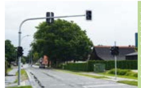
Dunkelampeln in der Grafschaft Bentheim zeigen für den Fuß- und Radverkehr kein Dauerrot, können aber bei Bedarf ausgelöst werden.
